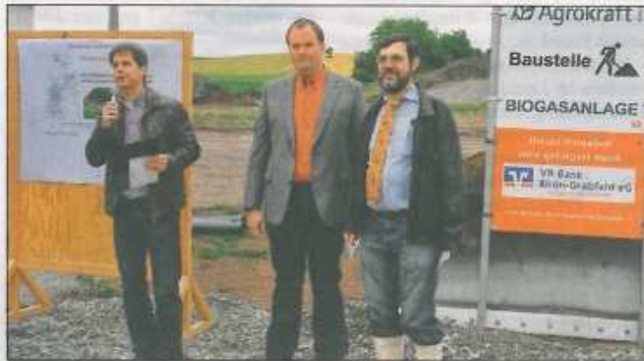
Die Teilnehmer am ersten Spatenstich wurden begrüßt (v. l.) von Mathias Klöffel, Marco Seith und Reinhold Behr.
