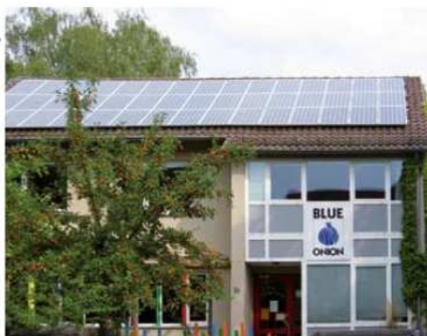
Auf dem Dach dieses Kindergartens ermöglichten sechs Gesellschafter eine Photovoltaikanlage mit acht Kilowatt.
