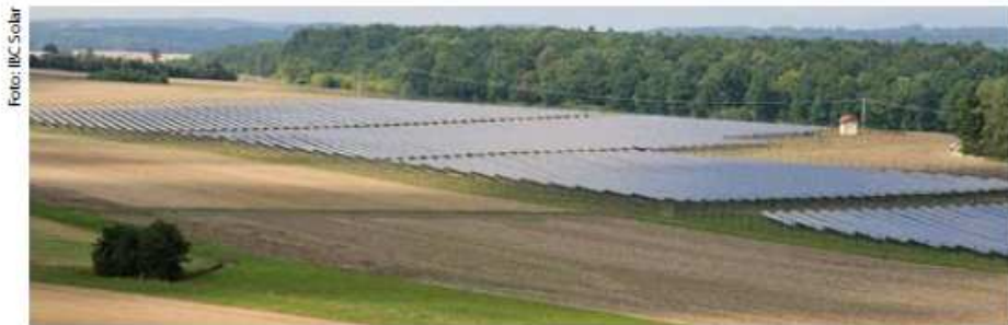
Die 1,8-Megawatt-Freiflächenanlage in Großbardorf war das erste Bürgersolarprojekt im Kreis Rhön-Grabfeld.
